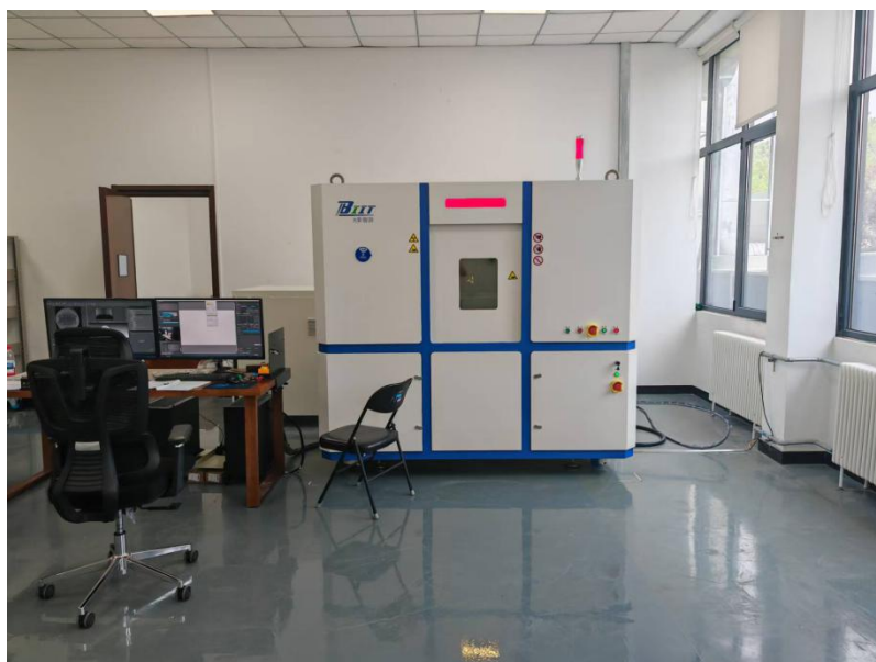
图2-4本项目CT安装后现场实物图
