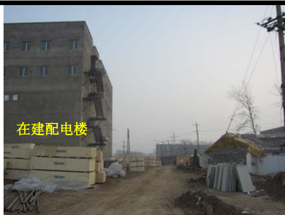
西北热电中心京能京西电厂北侧配电楼出线处
