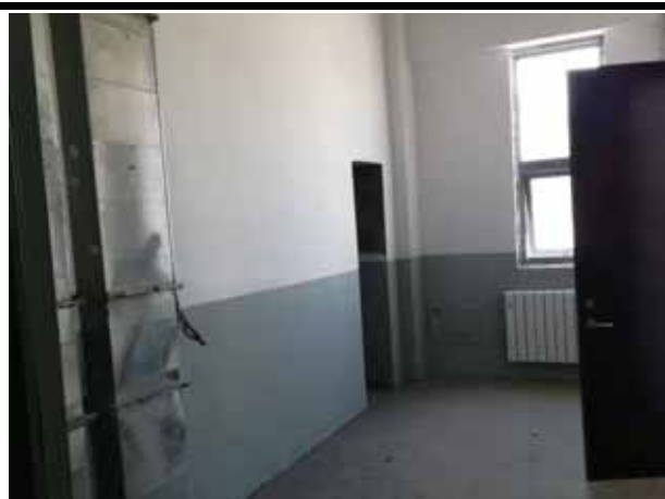
检测室北侧操作间
