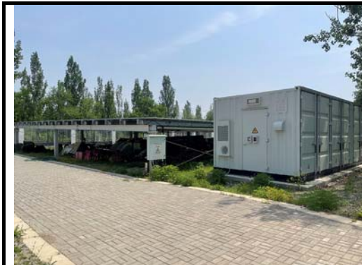
升压站站址：太阳能电池板方阵、储能集装箱
