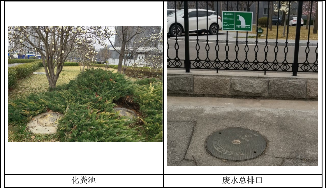
图 10 废水治理设施及排放口照片
